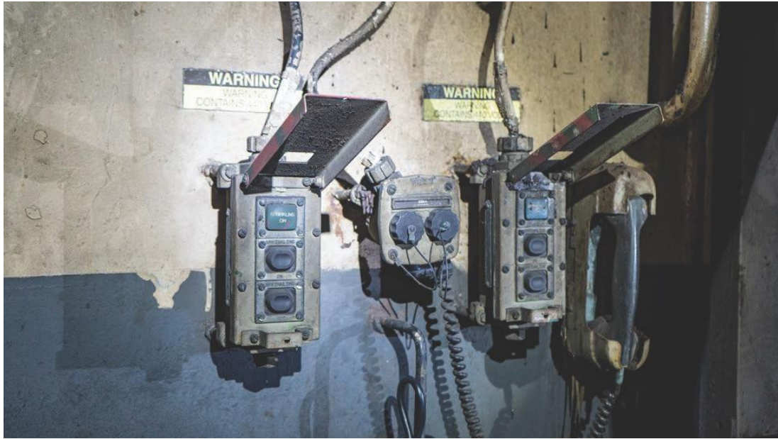
Resim – 5 Kapakları açık (solda 16; sağda 15) Alt V güverteye hizmet veren sprinkler grupları 15 ve 16 için AFFF butonlarının fotoğrafı. Bu basmalı butonlar, gemi ortasında Üst V güvertededir. 80
