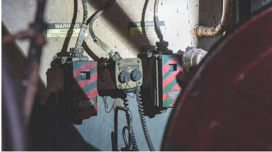
Resim – 4 Kapakları kapalı (solda 16; sağda 15) Alt V güverteye hizmet veren sprinkler grupları 15 ve 16 için AFFF butonlarının fotoğrafı. Bu basmalı butonlar, gemi ortasında Üst V güvertededir. 79
